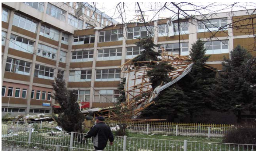
Slika 1: Srušena krovna konstrukcija sa zgrade bolnice u Gostivaru
