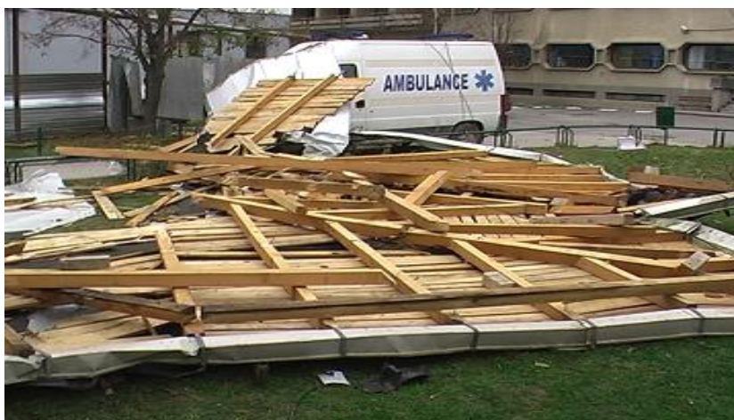
Slika 2: Srušena krovna konstrukcija sa zgrade bolnice u Tetovu
